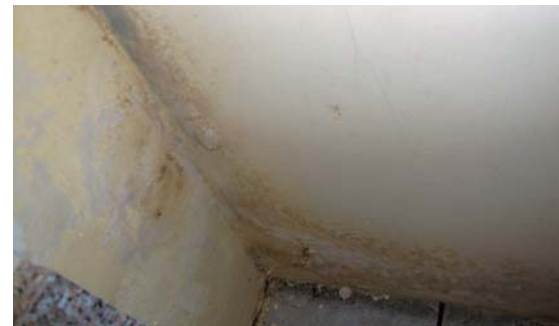
Feuchte Wände und zerstörtes Mobliar – die Wohnung der Familie G. Fotos: Sanmann
