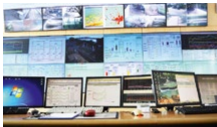
Leitzentrale im Klärwerk Köhlbrandhöft. Foto: stahlpress
