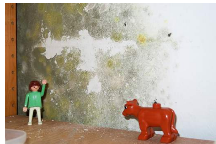
Diplom-Ingenieur und Gutachter Manfred Steinröx hält mit seiner Kamera fest, was er in Hamburgs Mietshäusern vorfindet. Das MieterJournal veröffentlicht in jeder Ausgabe eines seiner Bilder und erzählt die Geschichte hinter dessen Entstehung.
